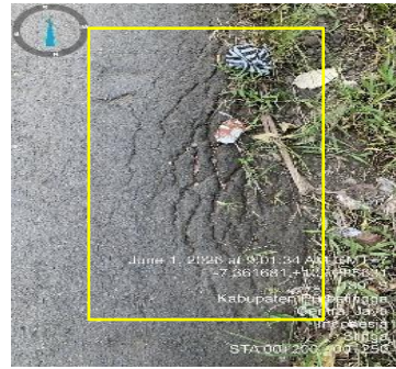
Gambar 16. Kerusakan Jalan Edge Cracking
