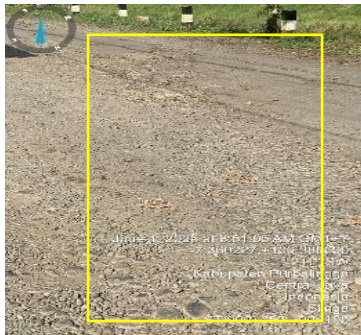
Gambar 7. Kerusakan Jalan Pelepasan Butir dan Lubang
