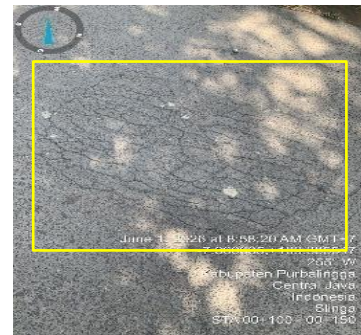
Gambar 9. Kerusakan Jalan Alligator Cracking
