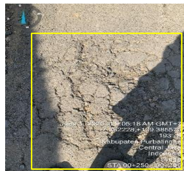
Gambar 22. Kerusakan Jalan Alligator Cracking
