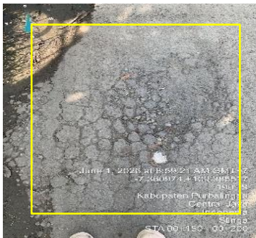
Gambar 11. Kerusakan Jalan Edge Crack dan Alligator Cracking
