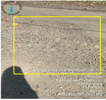
Gambar 6. Kerusakan Jalan Ambblas dan Lubang ( Pothole )
