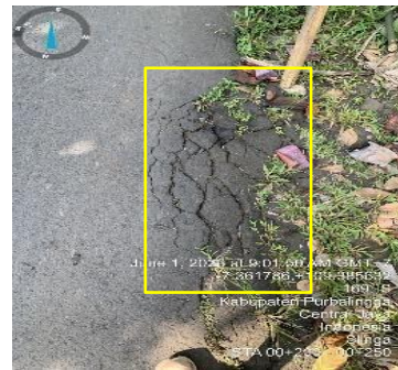
Gambar 17. Kerusakan Jalan Edge Cracking
