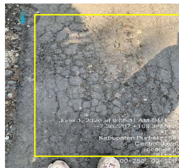
Gambar 21. Kerusakan Jalan Edge Cracking
