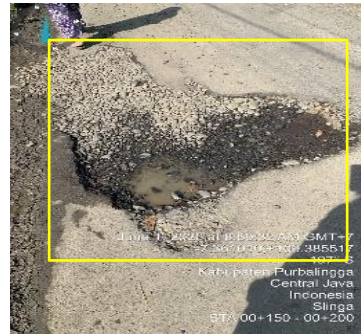
Gambar 12. Kerusakan Jalan Lubang ( Pothole )
