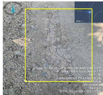
Gambar 5. Kerusakan Jalan Edge Cracking
