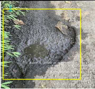
Gambar 14. Kerusakan Jalan Lubang (Pothole)
