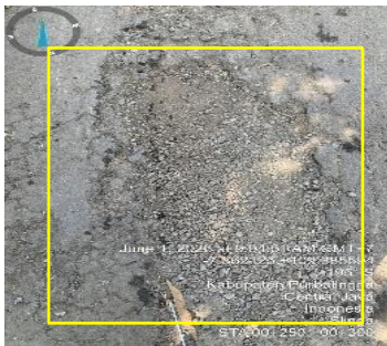
Gambar 19. Kerusakan Jalan Lubang (Pothole)
