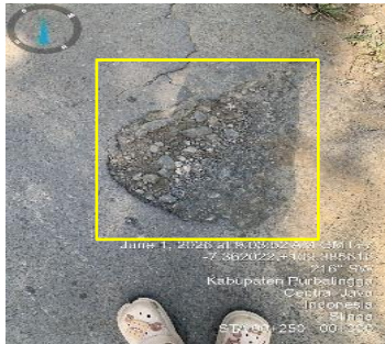
Gambar 18. Kerusakan Jalan Lubang (Pothole)
