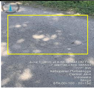
Gambar 10. Kerusakan Jalan Alligator Cracking
