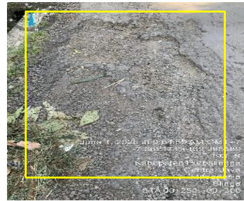
Gambar 20. Kerusakan Jalan Edge Cracking dan Lubang
