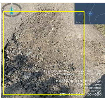
Gambar 3. Kerusakan Jalan Amblas ( Depression )
