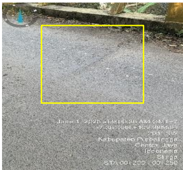
Gambar 15. Kerusakan Jalan Retak Memanjang
