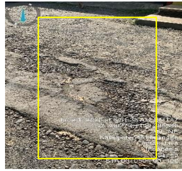
Gambar 8. Kerusakan Jalan Pelepasan Butir dan Ambblas
