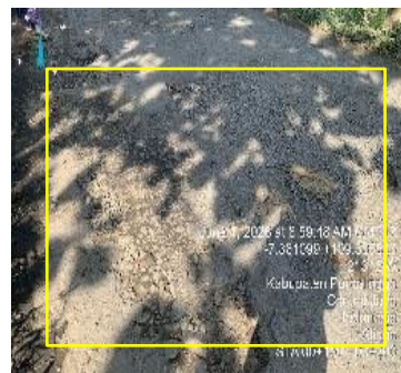
Gambar 13. Kerusakan Jalan Amblas dan Lubang ( Pothole )
