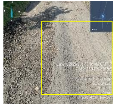
Gambar 4. Kerusakan Jalan Amblas dan Alligator Cracking
