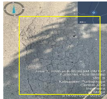
Gambar 1. Kerusakan Jalan Alligator Cracking
